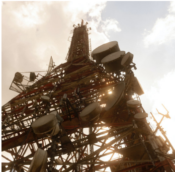
ဆက်သွယ်ရေးတာဝါများ Telecom towers
